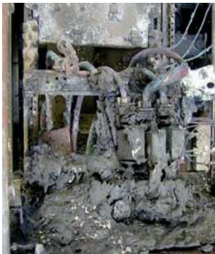
Nach einem Störlichtbogen ohne Störlichtbogenschutz.
