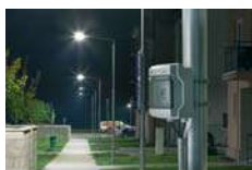
Beleuchtungssteuerung einer Wohnanlage mit Parkplatz
