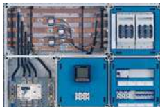
Wandlergehäuse mit Stromwandlern und Messgerätegehäuse
