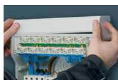
Optisch saubere Installation durch beigefügte Kabelzuführungsblende
