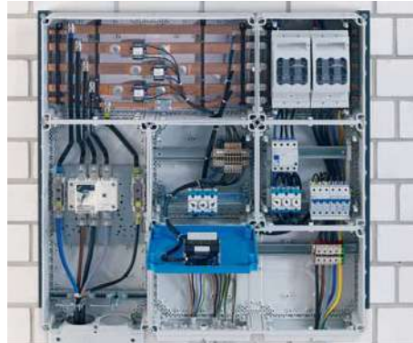
Messung mit Wandlergehäuse, Stromwandlern und Messgerätegehäuse
