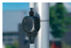
Energieversorgung einer Überwachungskamera im öffentlichen Raum
