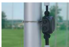
Beleuchtungssteuerung eines Sportplatzes
