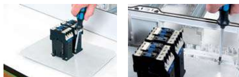
Geräteeinbau auf Montageplatte
