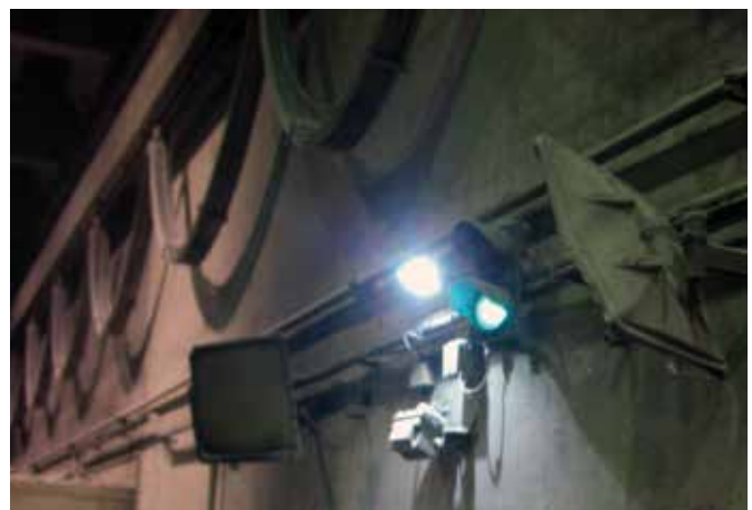
Halogenstrahler - Einsatzort Müllverbrennungsanlage
