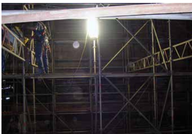
ApolloLIGHT - Einsatzort Kraftwerk
