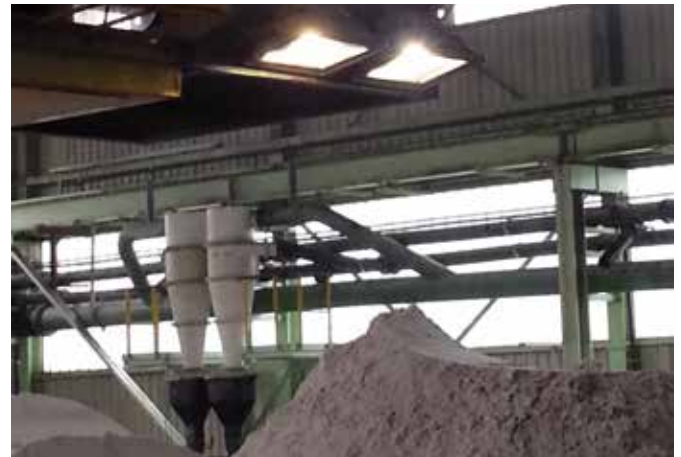
FlutLED 50 Watt - Einsatzort Quarzsandbunker
